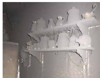
Beschädigter Hausrat kommt direkt in die Sanierungsstrecke des Unternehmens.
