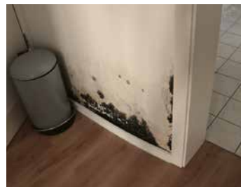
Hier lauern Gesundheitsschäden – die Beseitigung von Schimmelpilzbefall gehört zum Portfolio.
