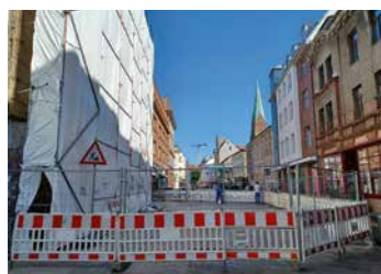
Sperrung in der Mecklenburgstraße
