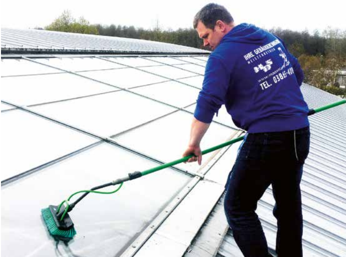
Solarmodule auf dem Dach müssen in regelmäßigen Abständen gereinigt werden. Foto: HDS
